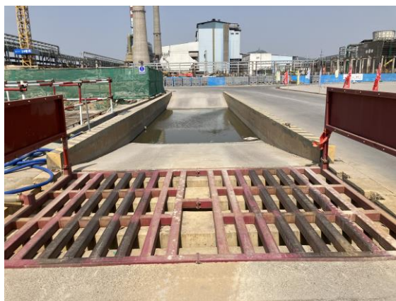
洗车平台（配套沉沙池）
